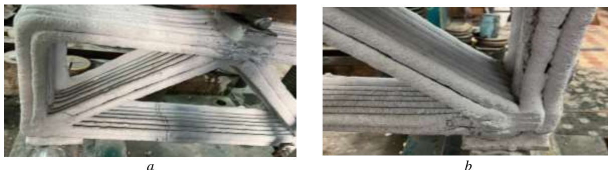
Fig.4. Overall view of cracks: a – first stage; b – second stage. Photo by K. Sirenok Рис.4. Загальний вигляд тріщин: a – перший етап; b – другий етап. Автор фото К. Сіренко
