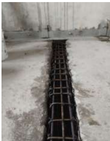
Fig. 19 Reinforcement of the cast-in-place beam. Photo by Dmytro Levkivskyi Рис.19 Армування монолітної балки. Автор фото Дмитро Левківський
