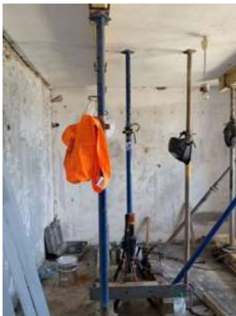
Fig. 6 Diagonal cracks in the floor slab. Photo by Andrii Zabrodskyi Рис.6 Діагональні тріщини в плиті перекриття. Автор фото Андрій Забродський
