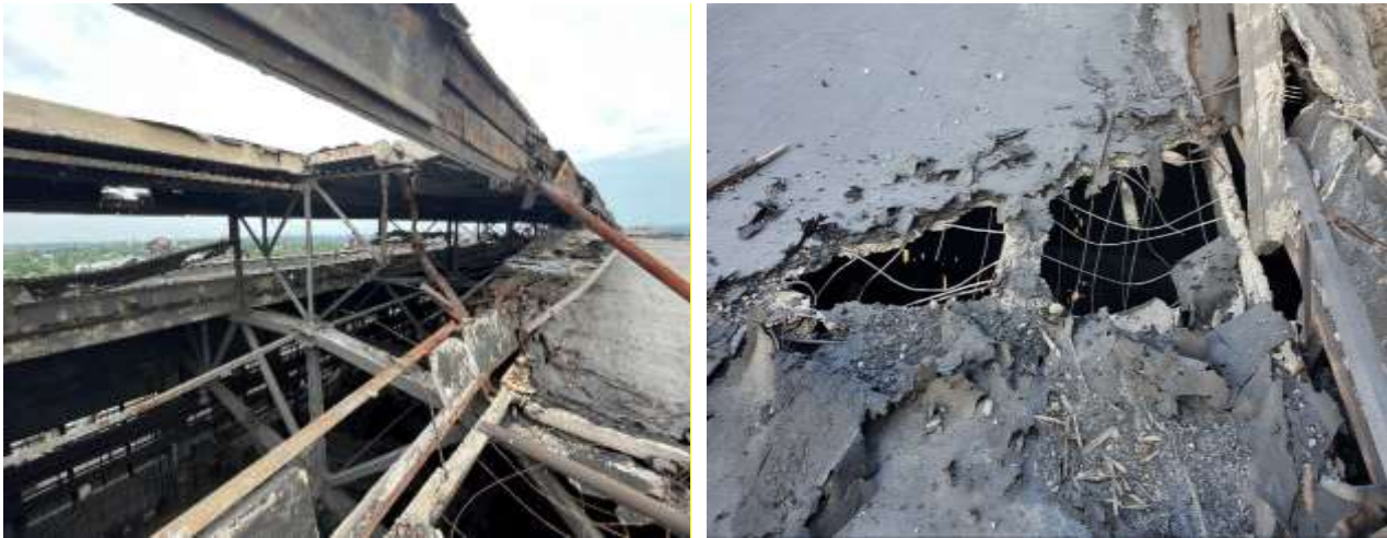
Рис. 1. Зруйновані плити покриття внаслідок артилерійського обстрілу. Фото 1. Д. Журавський, 2022 Fig. 1. Destroyed cover slabs as a result of artillery fire. Photos 1 by D. Zhuravskiy, 2022
