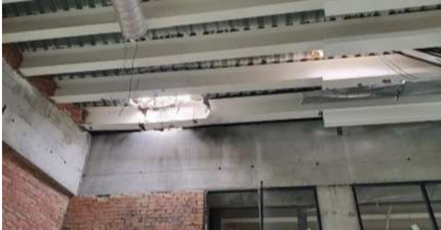
Рис. 2. Пошкодження сталевих конструкцій внаслідок прямого влучання боєприпасу. Автор фото Олександр Глітін
