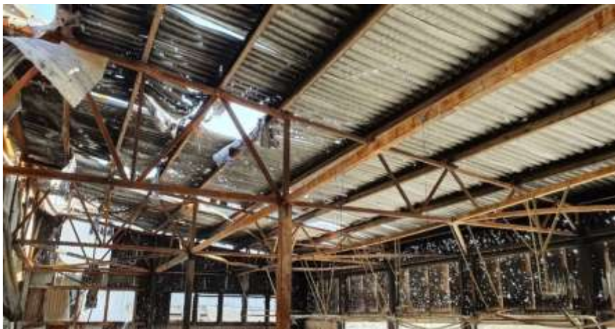
Рис. 3. Конструкції будівлі пошкоджені різними аспектами вибухових впливів. Автор фото Олександр Глітін
