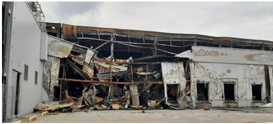
Рис. 3. Загальний вигляд пошкодженого об'єкту (вигляд з північної сторони). Автор фото Доброхлор М.І.
