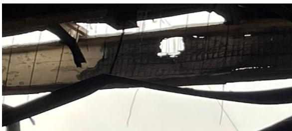
Рис. 8. Пошкодження стінки двотаврової балки від потрапляння боєприпасів. Автор фото Доброхлоп Є. Fig. 8. Damage to the wall of an I-beam from ammunition impact. Photo by Dobrokhlop Ye.
