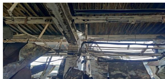
Рис. 10. Руйнування захисного шару балки. Автор фото Доброхлоп Є. Fig. 10. Destruction of the protective layer of the beam. Photo by Dobrokhlop Ye.
