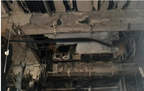
Рис. 11. Пошкодження круглопустотних плит перекриття і балок в зоні високотемпературного горіння.
