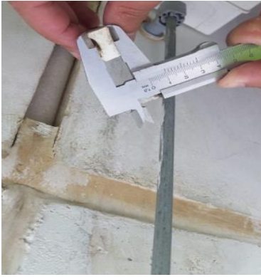
Рис.1. Пошкодження герметика у зв'язку з недотриманням технології виконання робіт
