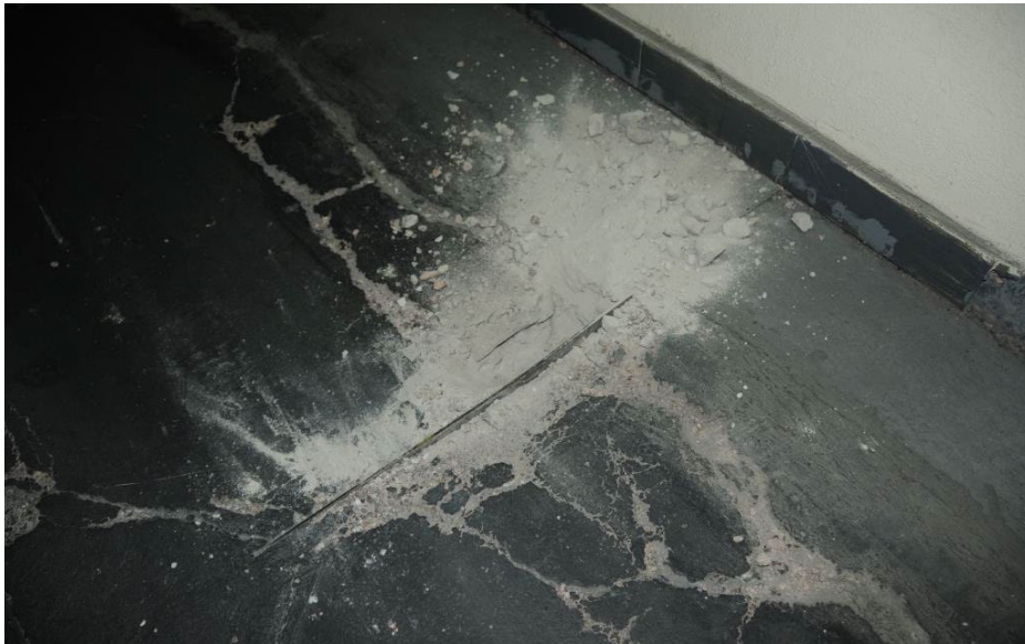
Рис.2. Загальний вигляд конструкції підлоги пошкодженої плити перекриття.
