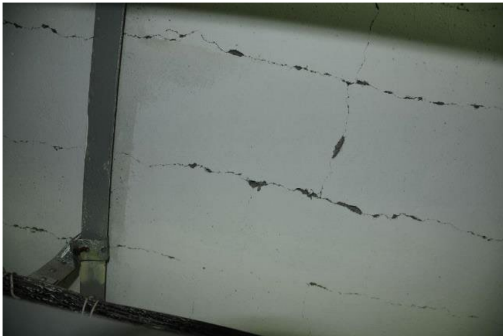
Рис.1. Загальний вигляд нижньої поверхні пошкодженої плити перекриття.
