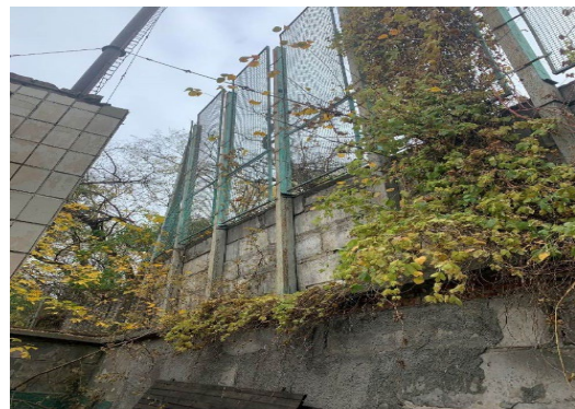
Рис. 7. Відхилення від вертикалі огорожувальних конструкцій стадіону, внаслідок просідання та зсуву ґрунту
