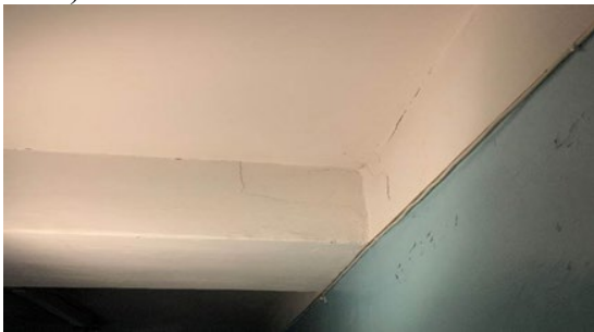
Рис. 5. Тріщина на опорній частині залізобетонного ригеля перекриття по осі «б» в осях «Г–Д», третього поверху
