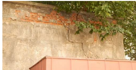
Рис. 6. Тріщина у підпірній стінці w_k=10\text{...}30 мм, руйнування оздобленого шару штукатурки і морозна деструкція цегляної кладки
