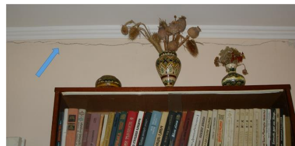
Рис. 5. Горизонтальна відривна тріщина в перегородці 1-го поверху
