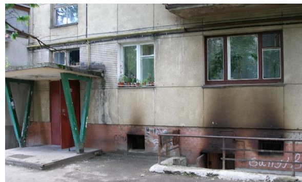
Рис. 1. Фрагмент фасаду будівлі з наслідками пожежі
