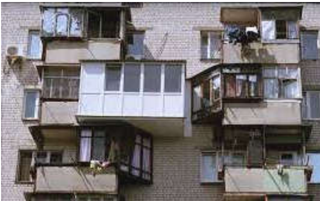
Рис.1. Добудовані балкони по фасаду житлового будинку
