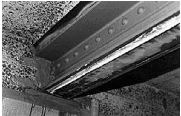
Рис.1. Підсилення існуючих балок двома пластинами з вуглецевого волокна. Транспортний міст Слаттокса, Англія. Fig.1. Strengthening of existing beams by two CFRP-plates. Slattocks Canal Bridge, England.
