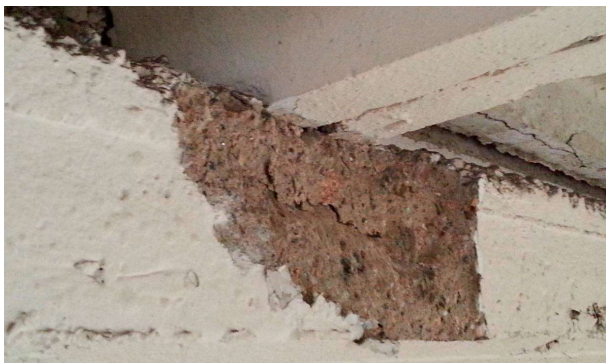
Рис.8. Відкол бетону в полиці залізобетонної балки в місці обпирання на балку поздовжнього ребра плити покриття.
