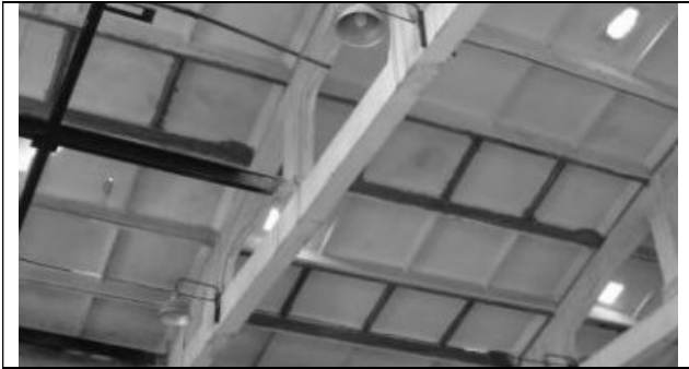
Рис.7. Підсилення поздовжніх і поперечних ребер залізобетонних плит покриття зовнішнім армуванням композитним матеріалом на основі вуглецевих волокон.
