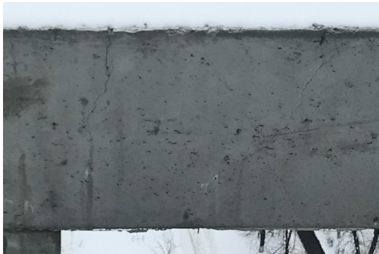
Рис. 3. Вертикальні та похилі тріщини в консольних балках. Fig. 3. Vertical and inclined cracks in cantilever beams.
