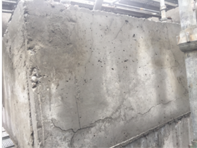
Рис. 2. Поверхнє розтріскування залізобетонної балки. Fig. 2. Surface cracking of reinforced concrete beam.
