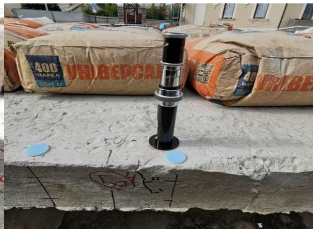
Рис.14. Вимірювання ширини розкриття тріщин Fig.14. Measurement of crack opening width
