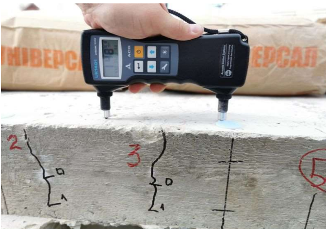
Рис.13. Вимірювання глибини розкриття тріщин Fig.13. Measurement of crack opening depth
