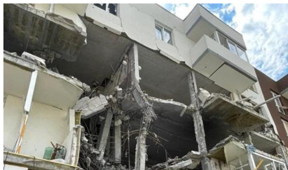
Рис. 1. Зруйнований каркасний п'ятиповерховий будинок у м. Буча, де відбулася руйнація несучих конструкцій в рівні третього, четвертого поверхів. Був демонтований
