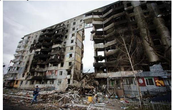
Рис. 4. Будинок у м. Бородянка з порушенням цілості секції
