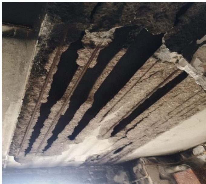
Рис. 13. Типовий характер руйнування круг-лопорожнистих плит під час тривалого вогню.
