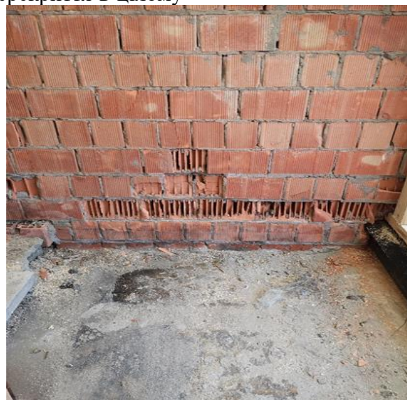
Рис. 12. Характер пошкодження порожнистих керамоблоків від високої температури. Fig. 12. Nature of damage to hollow ceramic blocks from high temperature
