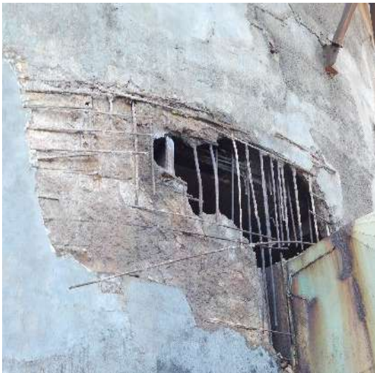
Рис. 4. Наскрізне руйнування стовбура, відсутність горизонтальної арматури
