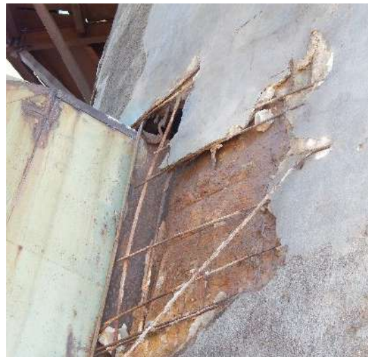
Рис. 5. Наскрізне руйнування стовбура біля ко- робу, відсутність шару бетону за арматуру зовнішньої сітки
