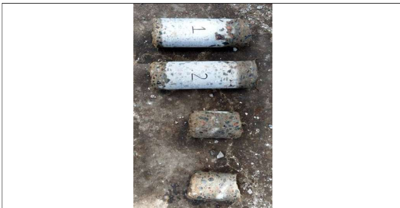
Рис. 6. Приклад глибини деградації бетону в межах товщини стовбура башти Fig. 6. Example of concrete degradation depth within the thickness of the tower trunk
