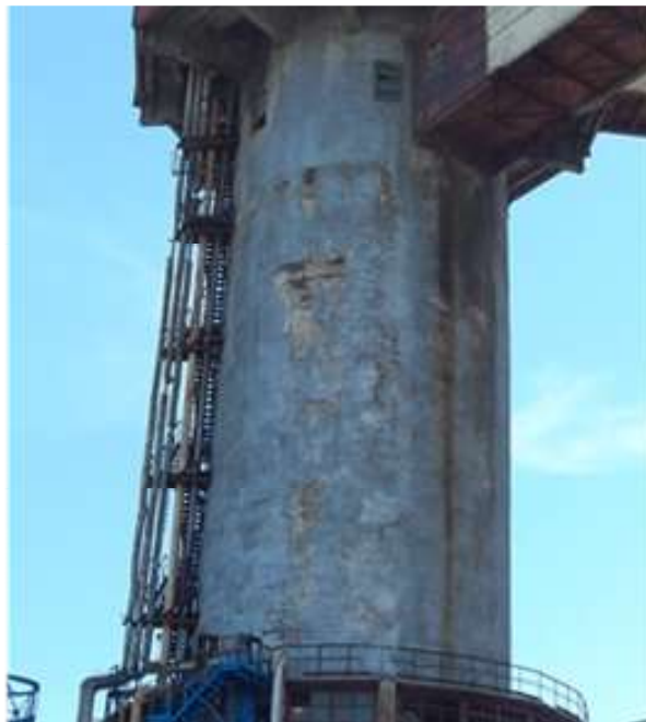
Рис. 1. Стівбур башти зі значними площами ділянок поверхневої деградації бетону Fig. 1. The tower trunk with large areas of concrete surface degradation
