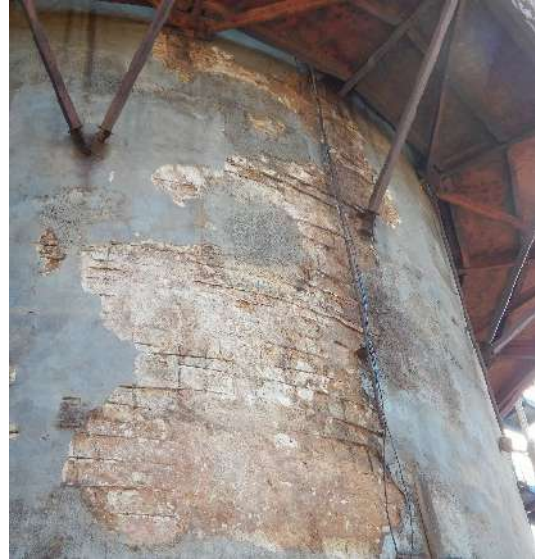
Рис. 3. Відсутність захисного шару бетону
