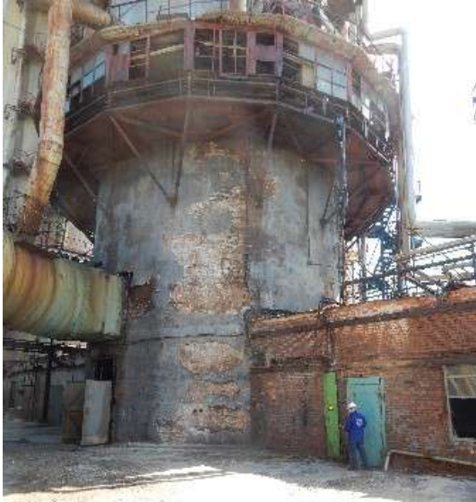
Рис. 2. Ділянки поверхневої деградації бетону у нижній частині стовбура башти
